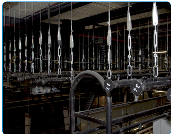
Die 40 Prospektzüge können jeweils mit 500 kg belastet werden und lassen sich mit 1,5 m/s. verfahren.
