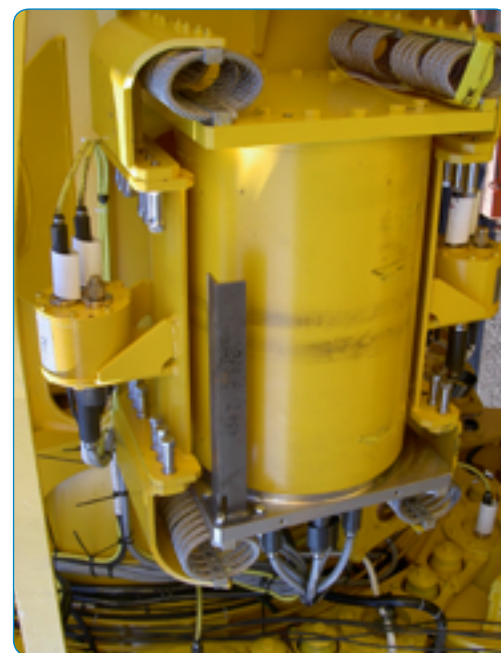
Ein druckdichter Behälter schützt die Steuerungs- und Überwachungskomponenten der MUX-Box.
